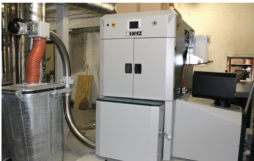
Nuova caldaia a cippato
