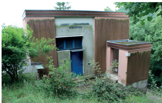
Stazione di filtraggio e potabilizzazione a Morbio Sup.
