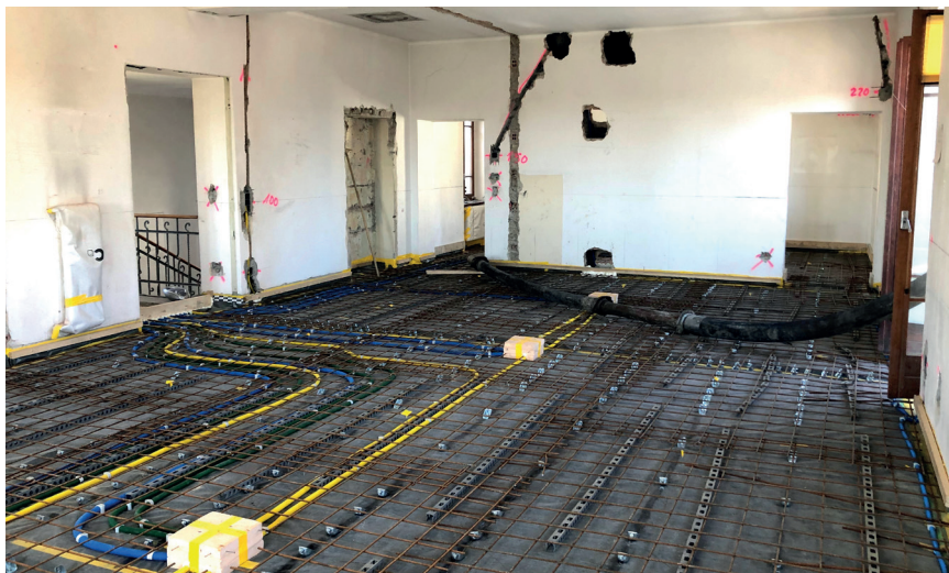
I rinforzi e i nuovi impianti eseguiti nel pavimento al primo piano.
