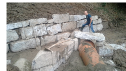
Dettaglio immissione acque chiare nel riale Vigino in zona Tognano
