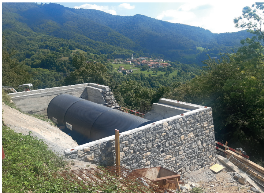
Il nuovo serbatoio dell'acqua potabile in zona Valsago.
