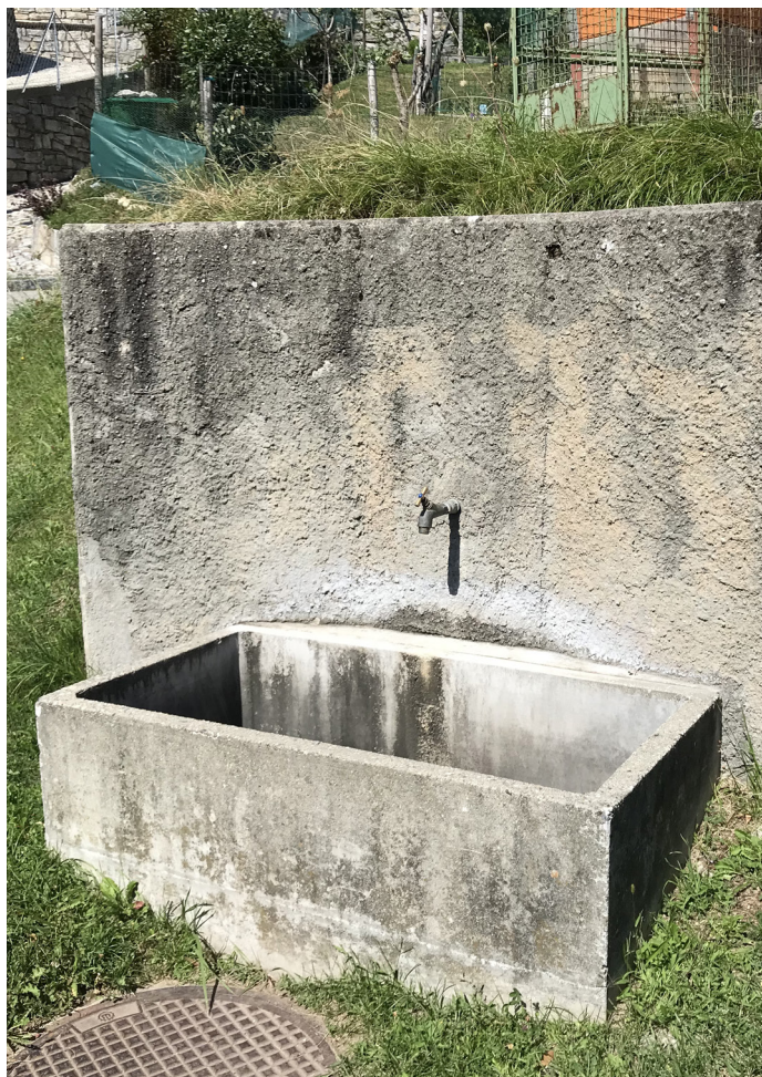
Img. 2: Situazione attuale della fontana ZEIC
