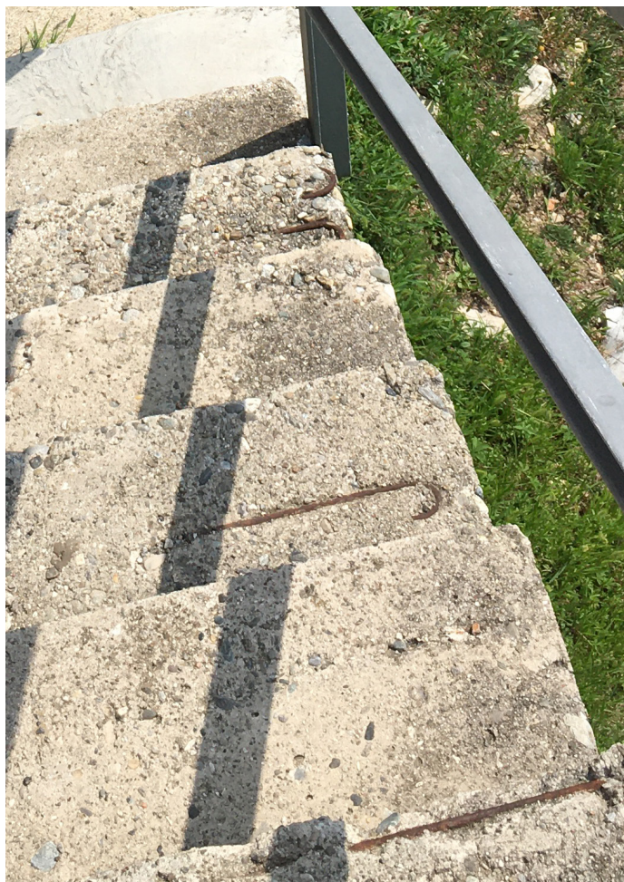
Img. 2: Dettaglio ferri d'armatura scoperti scala esistente
